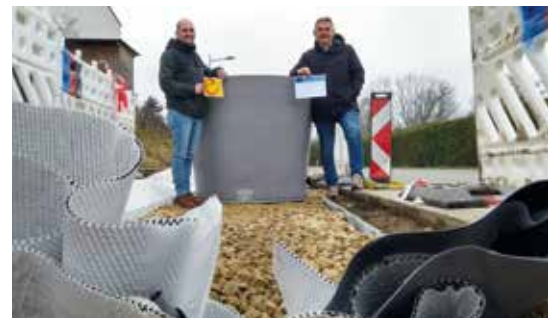
Bauamtsleiter Thomas Lichtenschopf (r.) und sein Kollege Patrick Gassner (l.) auf der Baustelle in der Rottenhauser Straße
