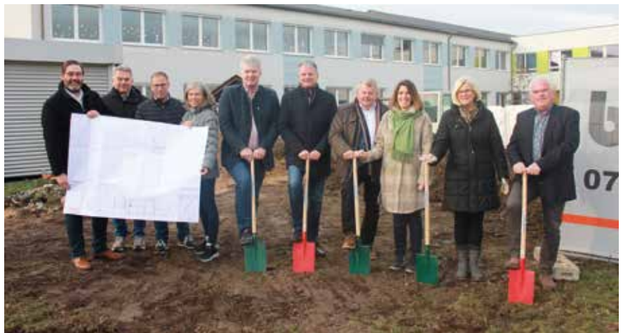
Spatenstich für den Zubau der Volksschule - v.l.n.r.: Franz Rafetzeder (Vorsitzender Prüfungsausschuss Volksschule), Bauamtsleiter Thomas Lichtenschopf, GR Helmut Brandl (Obmann Mittelschulausschuss), Hedda Leitner (Architekturbüro Haselmeyer), Bgm. Josef Leitner, StR. Gerhard Liebmann, Bgm. Karl Gerstl (Wieselburg-Land), Direktorin Waltraud Puppenberger (Mittelschule), Direktorin Helga Jungwirth (Volksschule), Bmstr. Günther Gschaider (Brachinger Bau)
